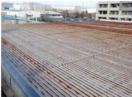
①屋根全体がサビてしまった倉庫の屋上。一部では亀裂などが原因による雨漏りも見られる。
